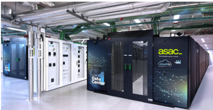
Ampliación del Data Center 1 de ASAC
