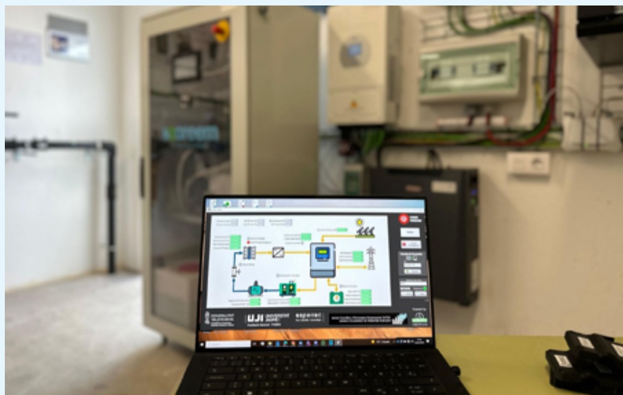
Imagen del demostrador de hidrogeno verde y su software de monitorización de datos
